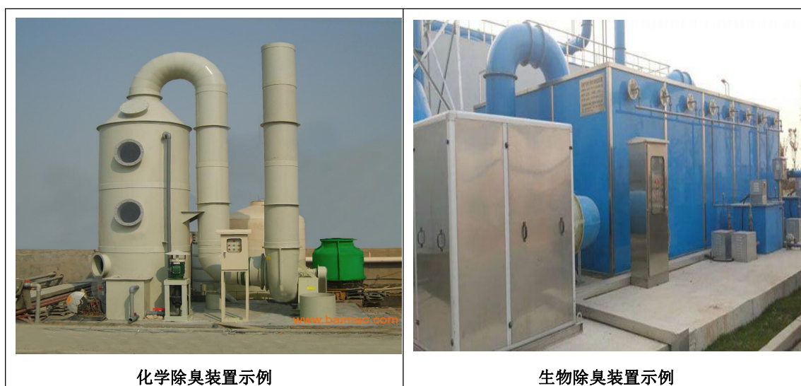
图 2.4-10 化学除臭和生物滤池除臭装置
